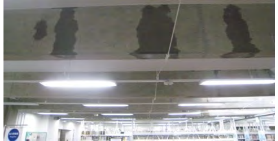
3) 天井亀裂からの水漏れ
