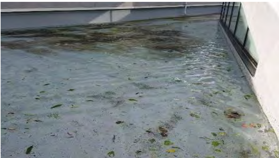
2) 屋上の雨水の溜まり
