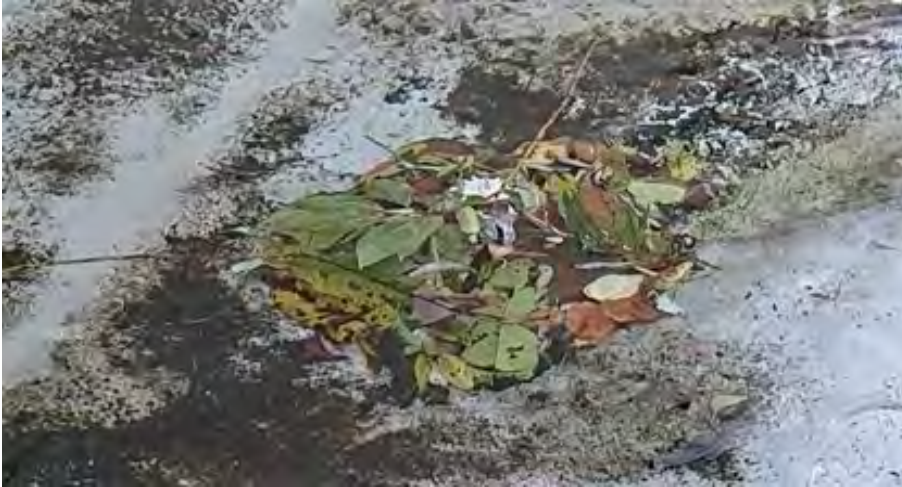
1) 屋上排水溝の詰まり
