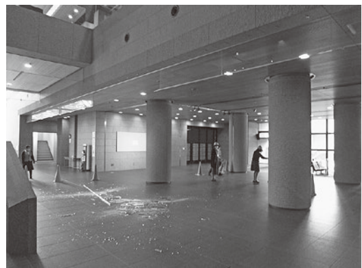
画像④ 防煙垂れ壁が落下した現場 館内ロビー床面にガラスが飛び散っている。
