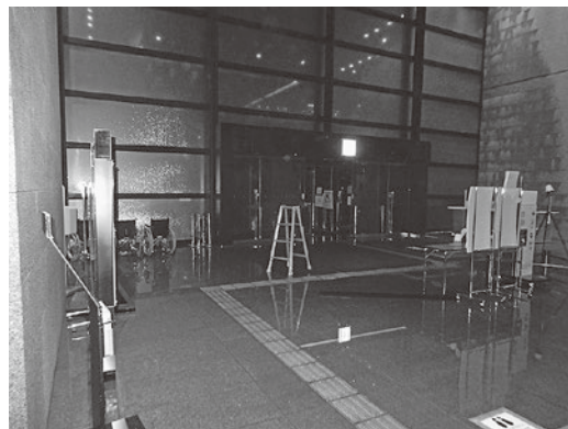
画像⑤ 水浸しになった入口ロビー 壁面近くの天井に設置されていたスプリンクラーから水が噴出し、画面右側の壁が天井近くから濡れている。床面は水浸しとなり、非常口の表示が反射している。
