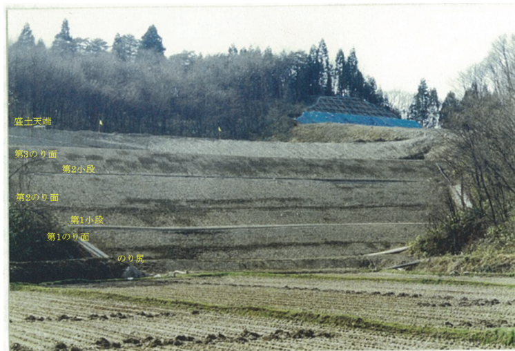
写真 6-6 植生工前の盛土の状況（水の浸みだし）
