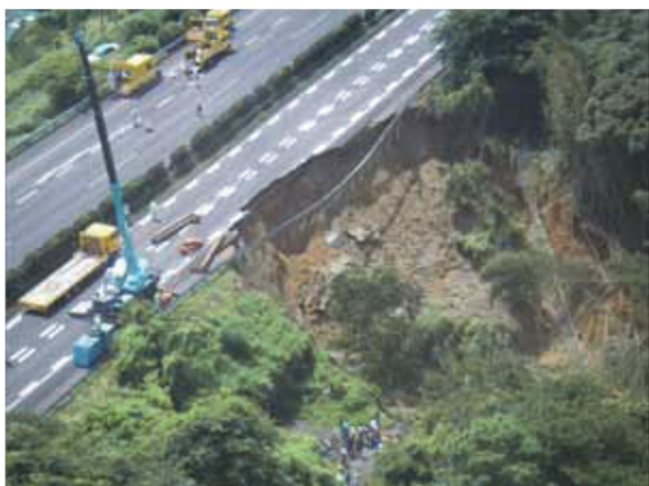
写真 1-1 東名高速道路牧之原 SA 付近の盛土のり面崩壊の状況 5)
