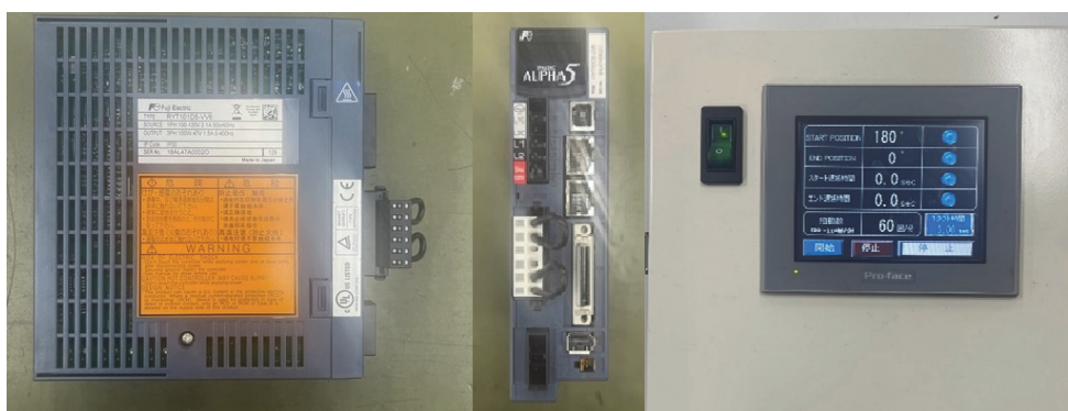
(A) サーボアンプ (B) 制御パネル
