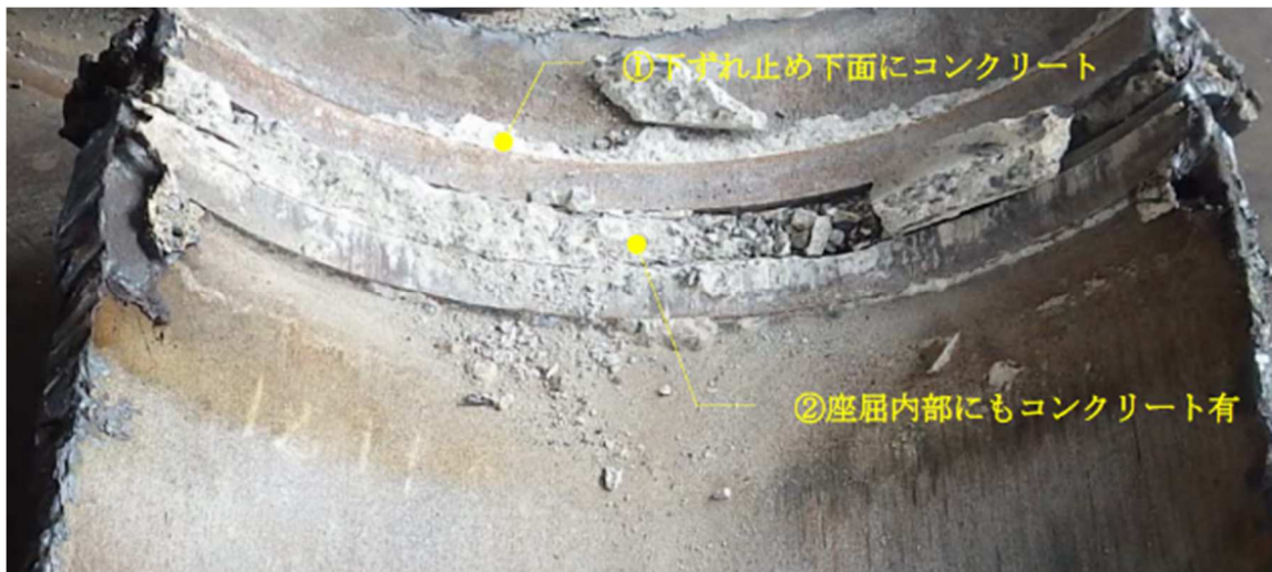
写真 4.8 試験後の鋼管内面の状況 (Case BA3)
