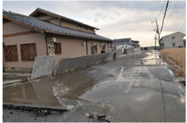
写真 1.10 液状化による被害（茨城県潮来市）
