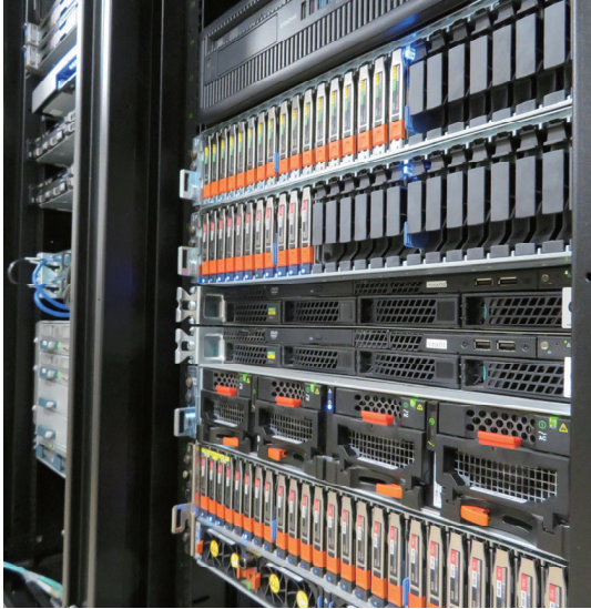
図1 電気通信研究所サーバールーム
