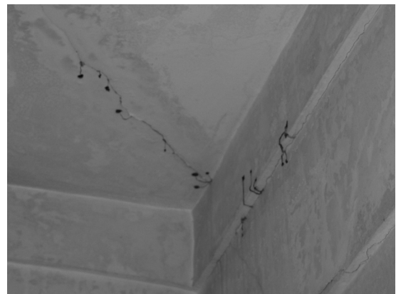
写真4 書庫内天井に発生したキノコ
