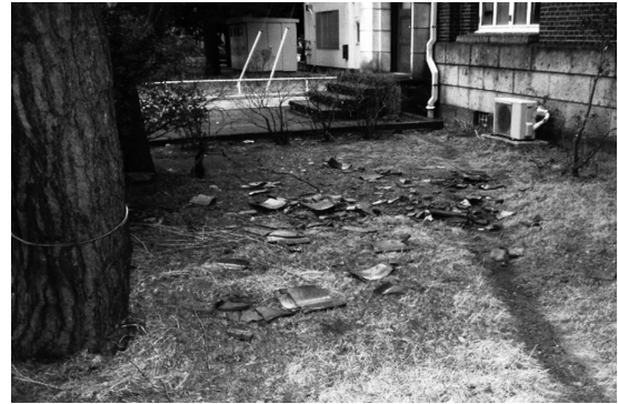
写真1 屋根から落下散乱した瓦
