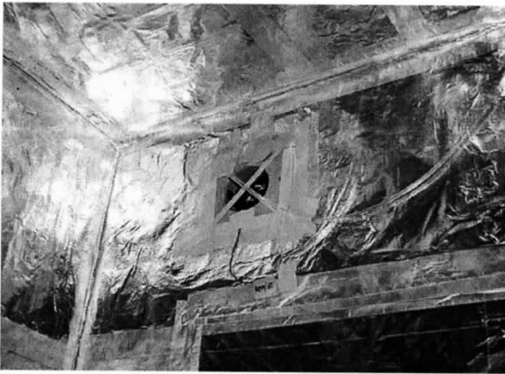
写真 3-8-62 2階両室の南側給気口
