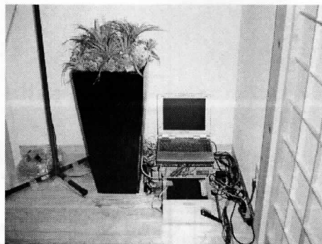
写真 4-5-43 1階の差圧計 (食堂)
