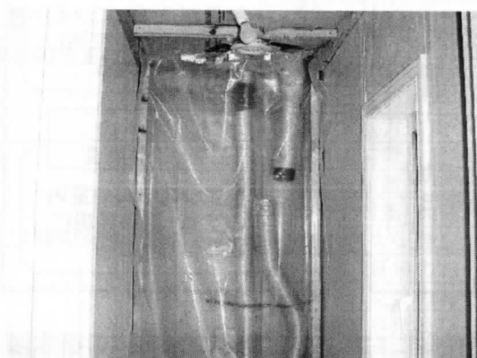
写真 4-3-1 ダクトの破損
