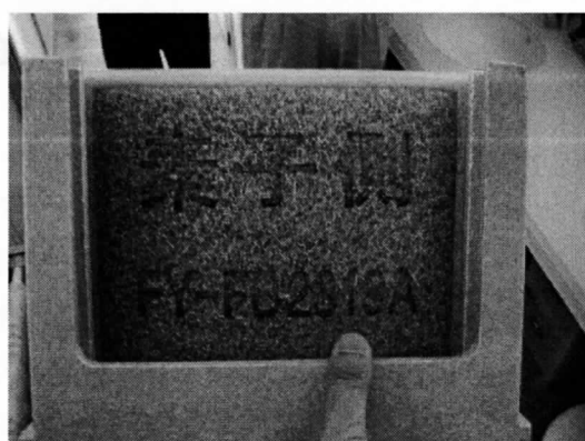
写真 3-5-4 給気側フィルター (住宅 A~E・G、熱交換ユニットに内臓)
