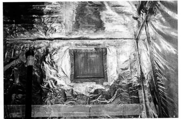
写真3-8-60 2階両室の南側給気口 (使用していないもの)
