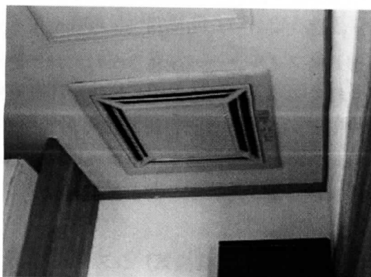
写真 3-5-12 熱交換ユニット排気口 (住宅 H、内部にフィルター有り)
