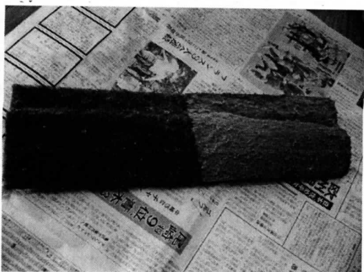
写真 3-5-11 熱交換ユニット排気側フィルター (住宅 H、左：清掃後、右：清掃前)
