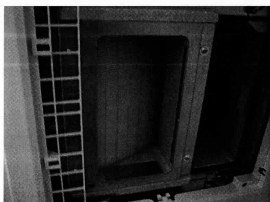
写真 3-5-3 熱交換ユニット内部 (住宅 A~E・G) (排気側・給気側フィルターを外した状態)
