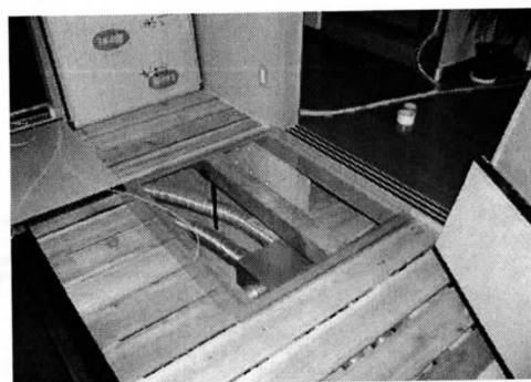
写真 3-8-11 和室の給気ガラル
