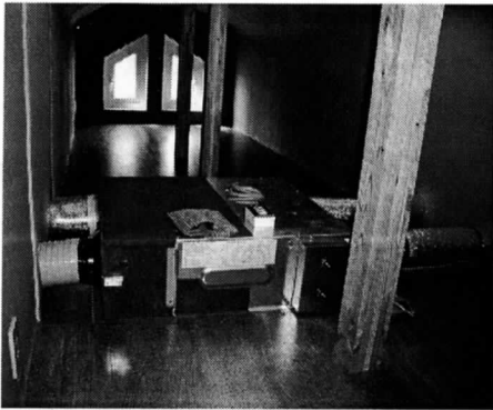
写真 3-8-29 熱交換ユニット (小屋裏)
