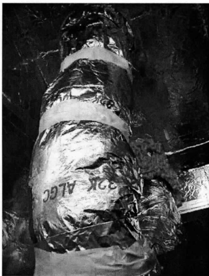
写真 3-8-67 パッシブダクト
