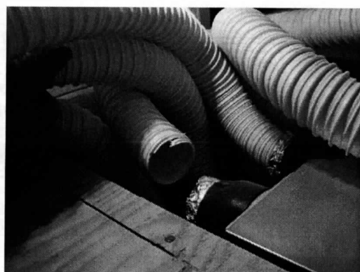
写真 4-3-2 ダクトの抜け落ち
