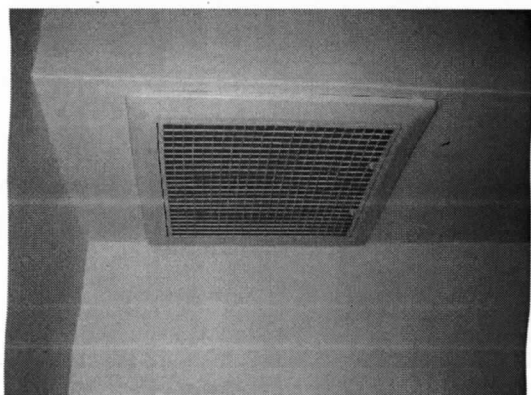
写真 3-5-1 熱交換ユニット排気側フィルター (住宅 A~E・G、目視可能)
