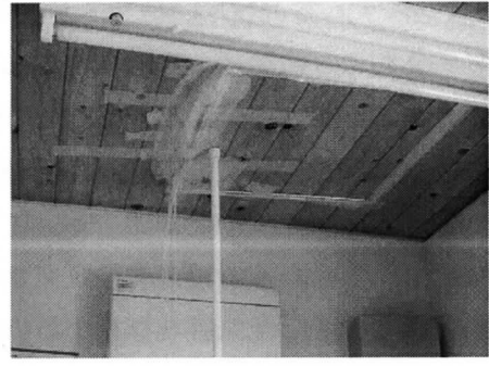
(b) 居室専用換気システム
