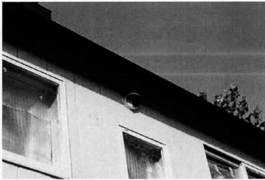
写真 3-8-55 外気取り入れ口
