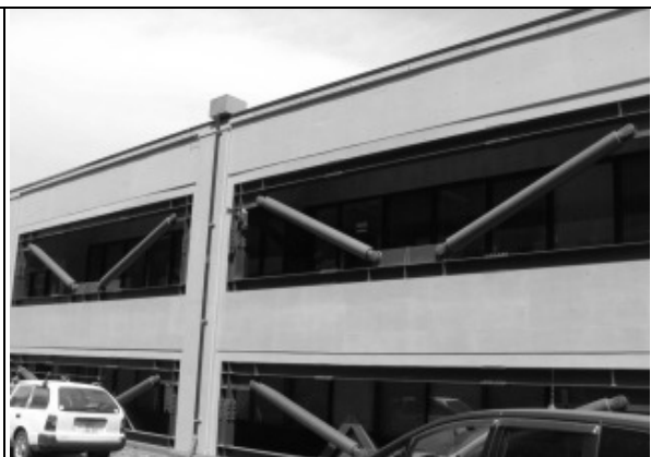
〔外窓〕 KT ブレース (円形鋼管)
